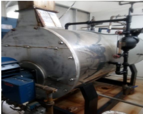
Fotografía No. 3 Caldera de 20 BHP
